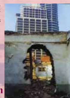
ジャン・ダーリー／張大力 「破壊(世界金融センター)」1998年 Zhang Dali "Demolition, World Financial Center" 1998
